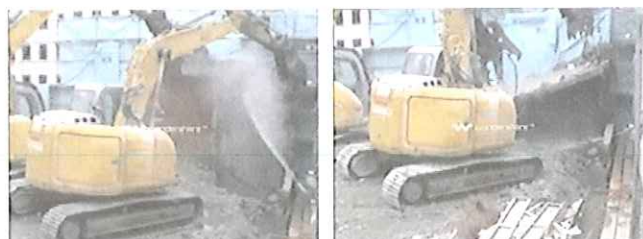
(a) 壁転倒前 (b) 壁転倒後
