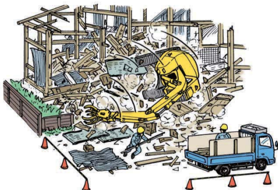
不安定ながれきの上で作業をしていた重機が転倒
