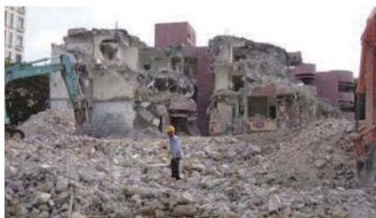
コンクリート塊のみならずレンガやブロックが混在している
