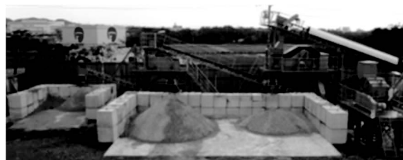
写真－1 再生骨材製造プラントの外観 4)
